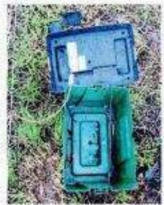
Das Elektrozaungerät ist zerstört, die Batterie entwendet worden.
